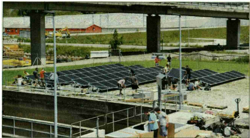
Die 180 Quadratmeter grosse Fotovoltaikanlage auf dem ehemaligen ARA-Firstfeld-Gebiet für den Betrieb der Laboranlage der «Basis57».
